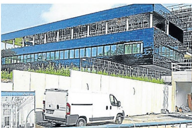
Problembaustelle Rhein-Mosel-Halle: Wann wird sie fertig? Foto: Frey
